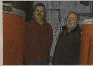
Umgerüstet: Jürgen Hurrlein vor der neuen Heizung. FOTO: HURRLIN
